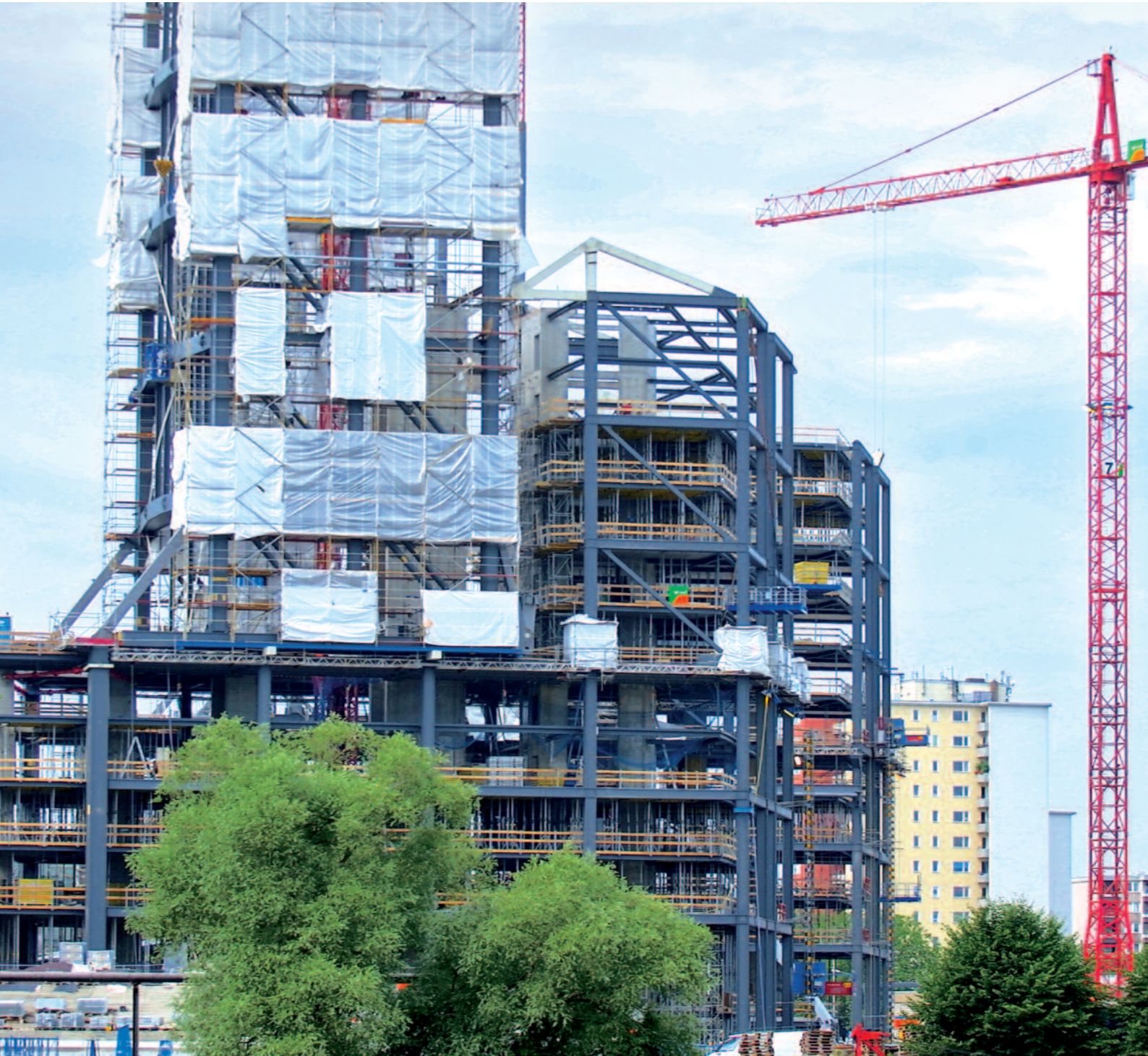
Bild 51: Stahlbaumontage beim Bau des Bürogebäudes am Berliner Hauptbahnhof (Architekt: gmp · von Gerkan, Marg und Partner Architekten, Berlin)
