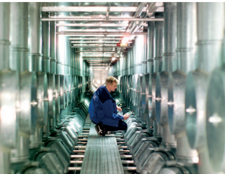
Bild 47: Die Haustechnik ist das Herz des Gebäudes und stellt die Weichen für eine nachhaltige Bewirtschaftung.
