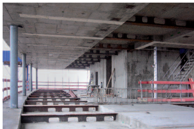
Bild 59: WestendDuo in Frankfurt: Die gefaltete Decke spart Bauhöhe und erlaubt eine flexible Medienführung. (Architekt: KSP Jürgen Engel Architekten, Frankfurt/Main)
