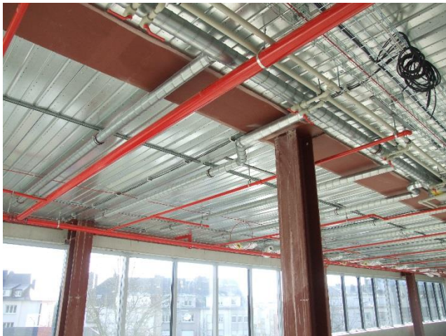
Bild 1: Störungsfreie Installation der Haustechnik bei Slim-Floor-Decken
